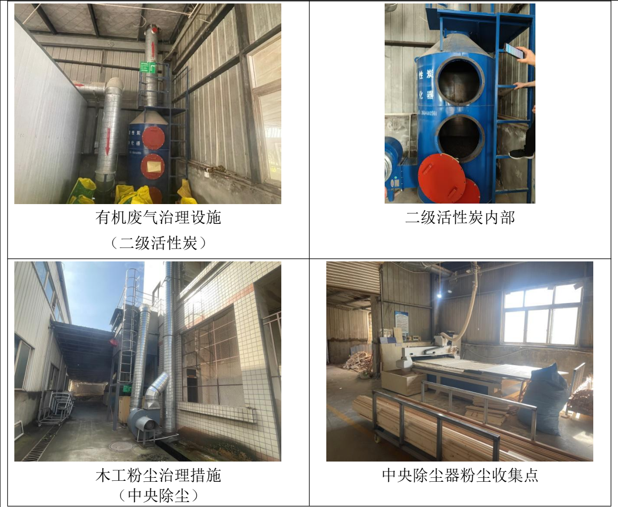
图 3 废气治理设施现场照片
