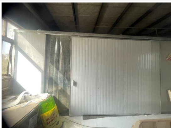
喷胶房封闭设施 （采取软帘+推拉门）
