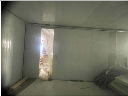
喷胶房封闭设施 （采取软帘+推拉门）
